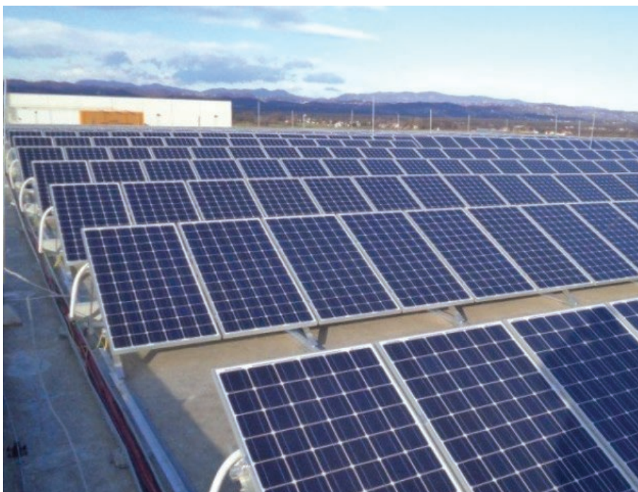
Slika 8.6. Fotonaponska elektrana Ricardo snage 325 kW e u Dardi, Baranja Izvor: (Šljivac 2013)
