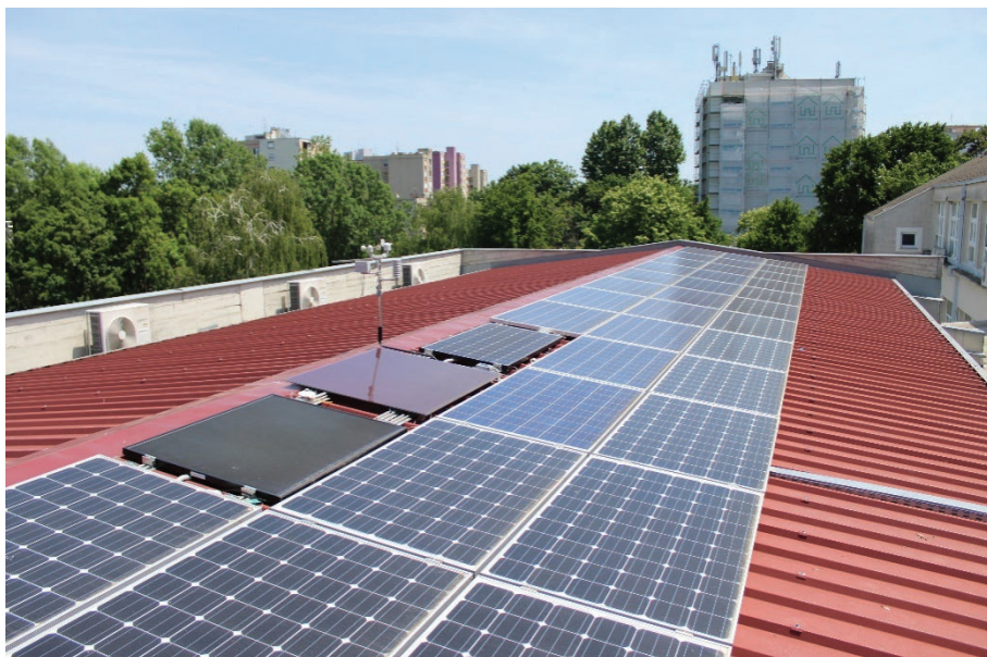
Slika 9.2. Vanjski dio laboratorija za obnovljive izvore energije
