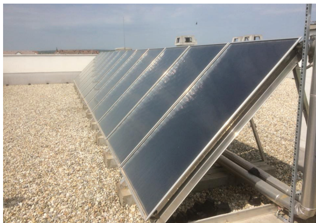
Slika 7.3. Solarni toplinski kolektori koji se koriste u Koprivnici na zgradi „Šparne hiže“
